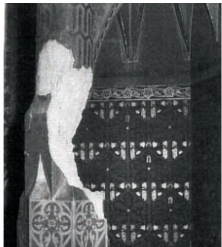
Oben: 1961 Geborstene Sandsteinsäule
