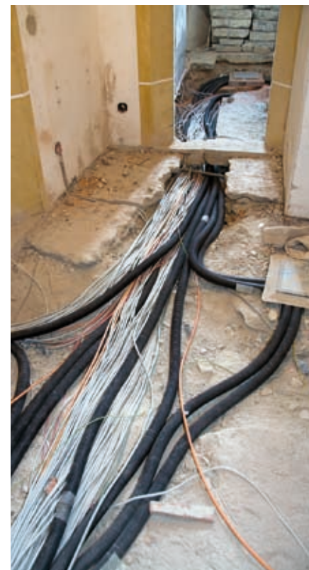
Unten: Elektroinstallationen in der Fußbodenebene
