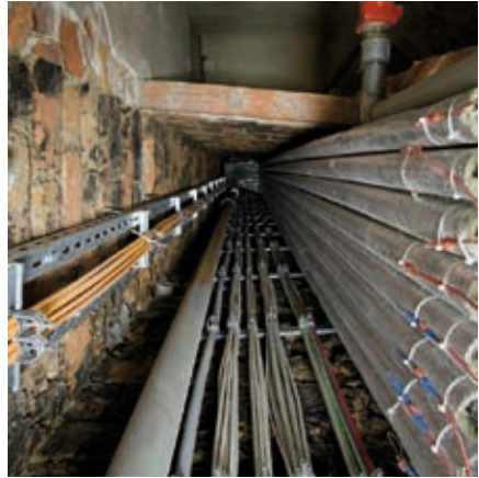
Oben: Schacht für Steigleitungen
