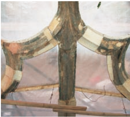
Oben: Risse in den Zellengewölben; Zustand 2006 nach Abnahme des Putzes
