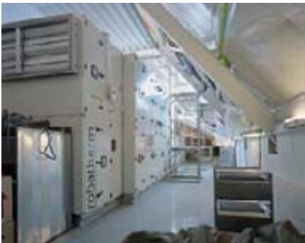
Die Technikanlagen befinden sich in den Bereichen des Altbaudaches. So kann das Volumen des Neubaus ausschließlich für die Deponierung genutzt werden.
