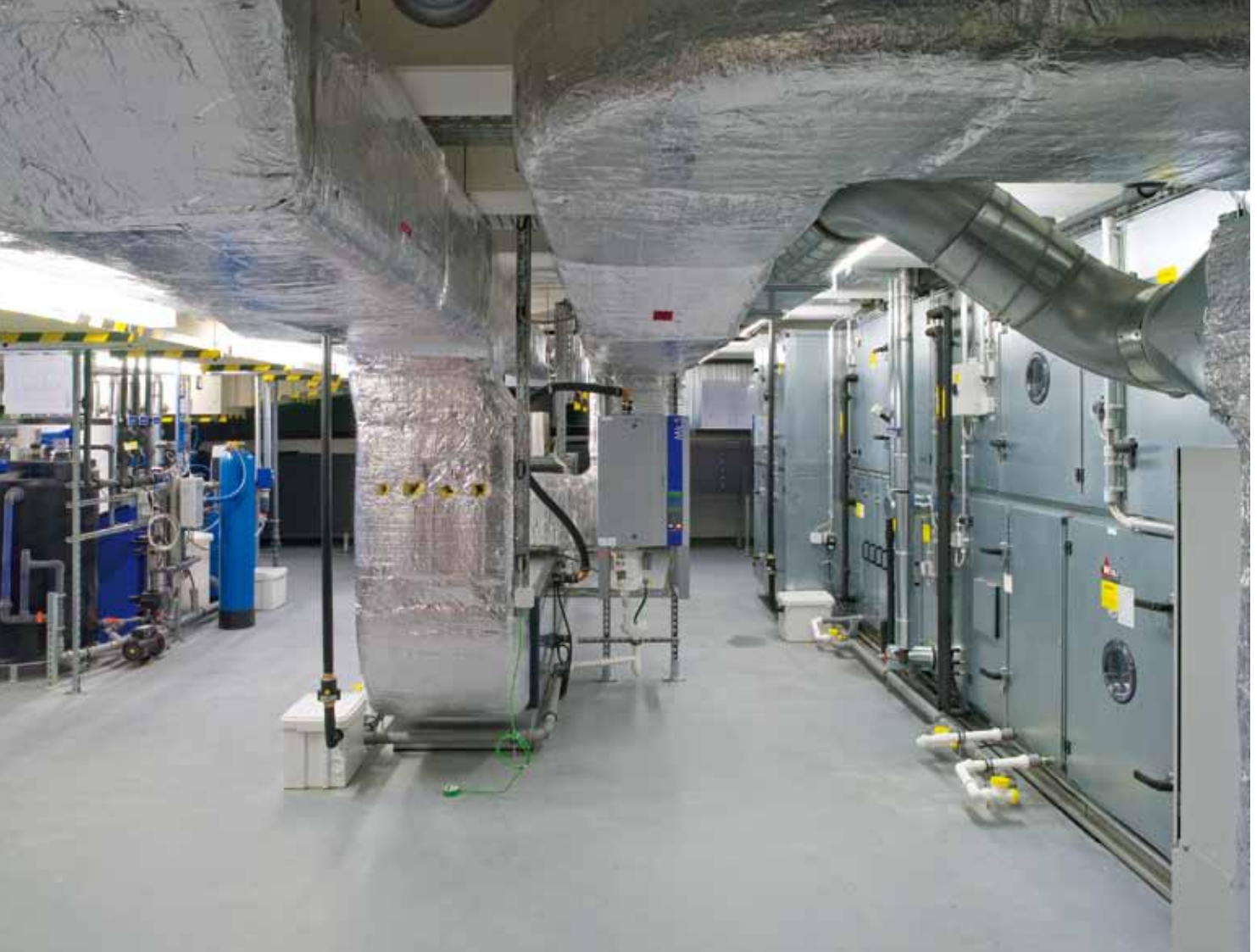
Technikzentrale im 1. Untergeschoss des Magazinneubaus
