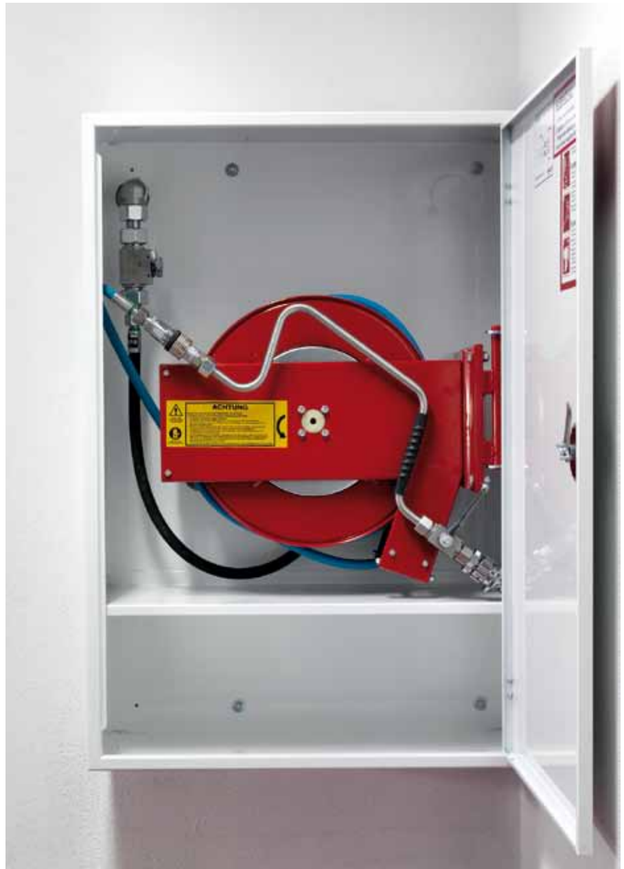
Wandhydrant mit Hochdruck-Wassernebellöscheinrichtung im Treppenhaus Magazinaltbau
