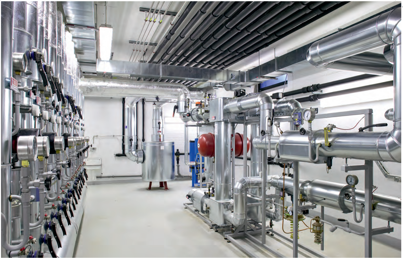
Die kontinuierliche Optimierung der technischen Anlagen wirkt der Kostensteigerungen bei Strom und Heizenergie entgegen.
