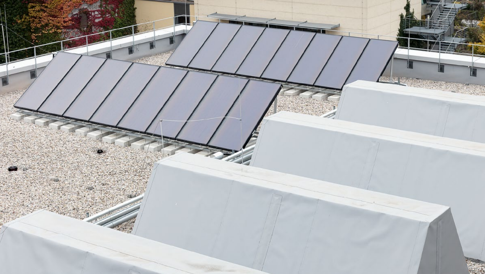
Solarthermieranlage auf dem Dach des Gebäudes für die Lernklinik und Bibliothek der Medizinischen Fakultät der Universität Leipzig und der Mensa des Studentenwerkes
