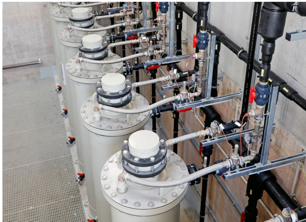
Geothermieranlage, Westsächsische Hochschule Zwickau
