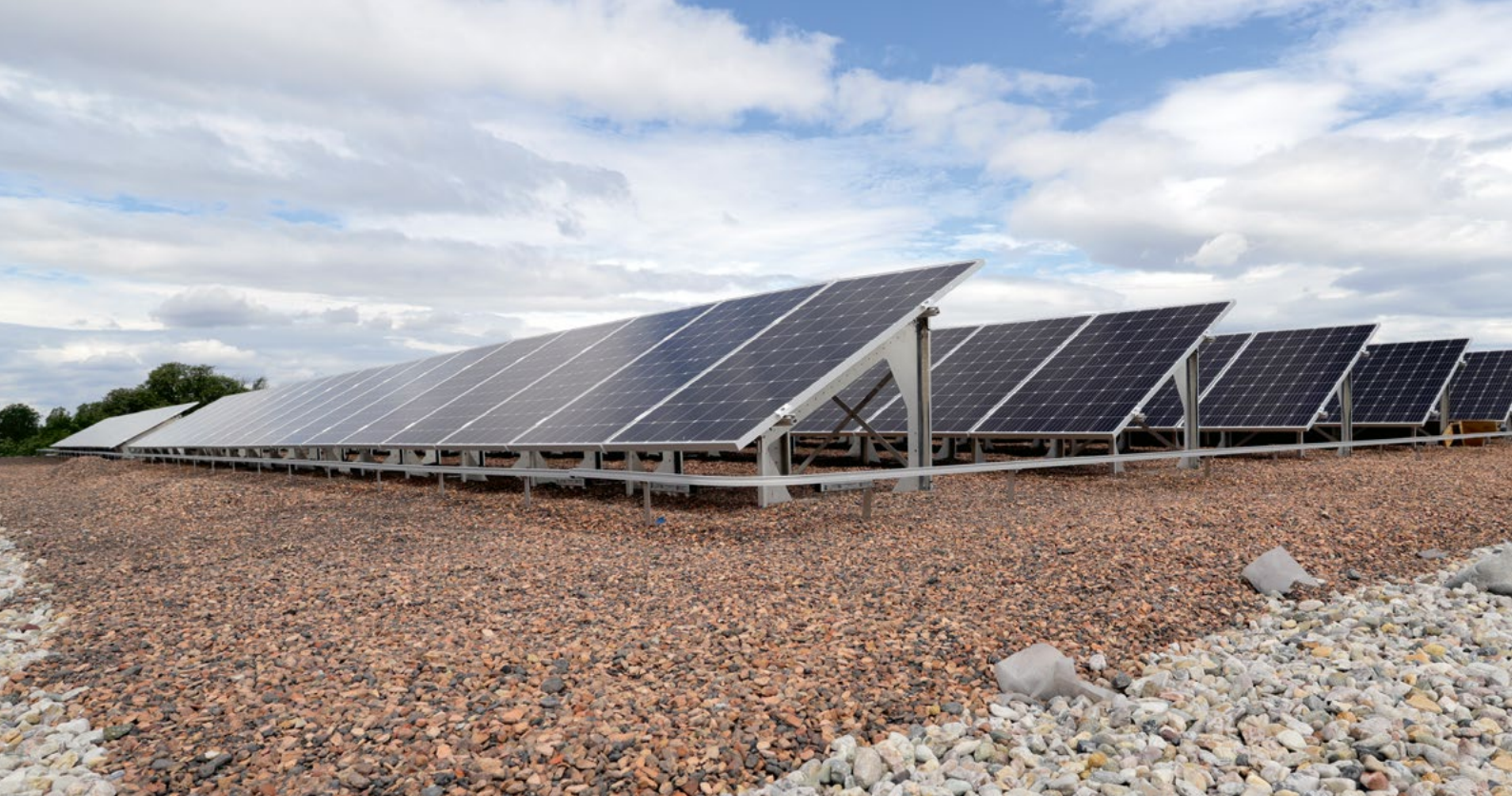
Photovoltaik-Anlage auf dem Dach der Sporthalle
