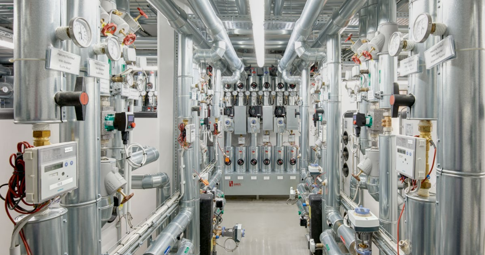
Wärmeversorgungszentrale im Neubau des Gerontopsychiatrischen Zentrums, Sächsisches Krankenhaus Großschweidnitz
