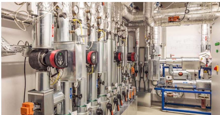
Die Instandhaltung technischer Anlagen ist Teil des Integrierten Facility Managements
